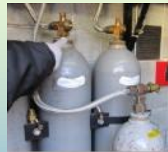
ガス系消火設備の保守点検
